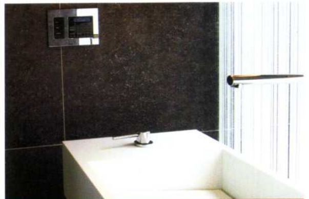
Les commandes du système domotique et audio-vidéo multiroom sont accessibles jusque dans la salle de bains aussi bien pour choisir un morceau de musique et régler le son que pour ajuster l'intensité du chauffage.
